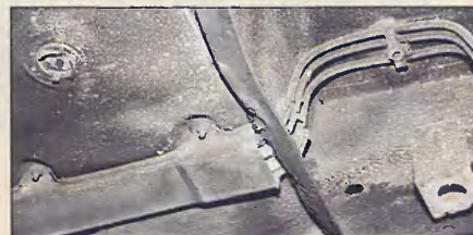
Магистрали под днищем защищены стальными кожухами.
